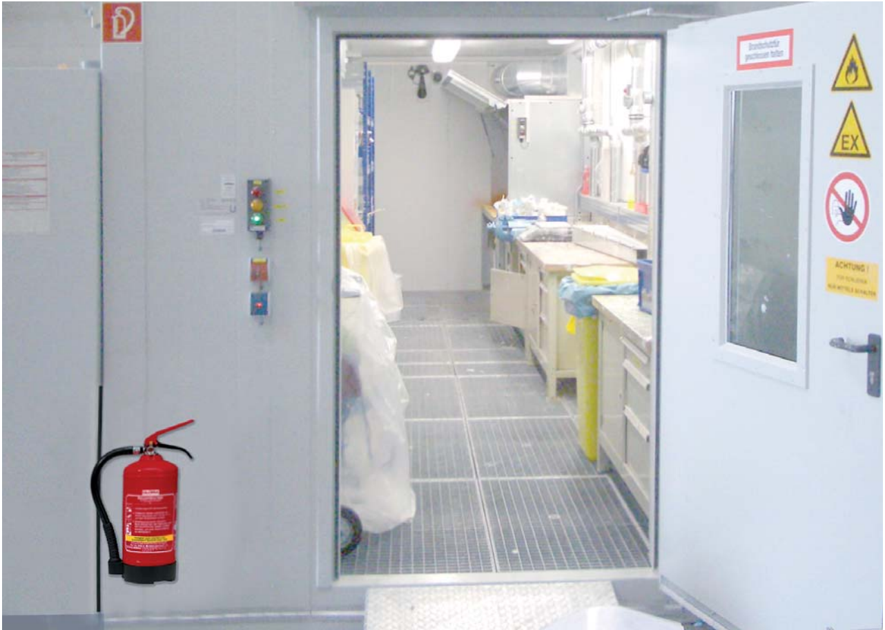
Das begehbare F90-System mit integriertem Gefahrstoffarbeitsplatz und Absaugung im Einsatz. Das Lager verfügt über eine T90-Tür mit integrierter F90-Verglasung sowie Alarm- und Signalleuchten plus Schalter für Beleuchtung und Türfeststellaufleger.
